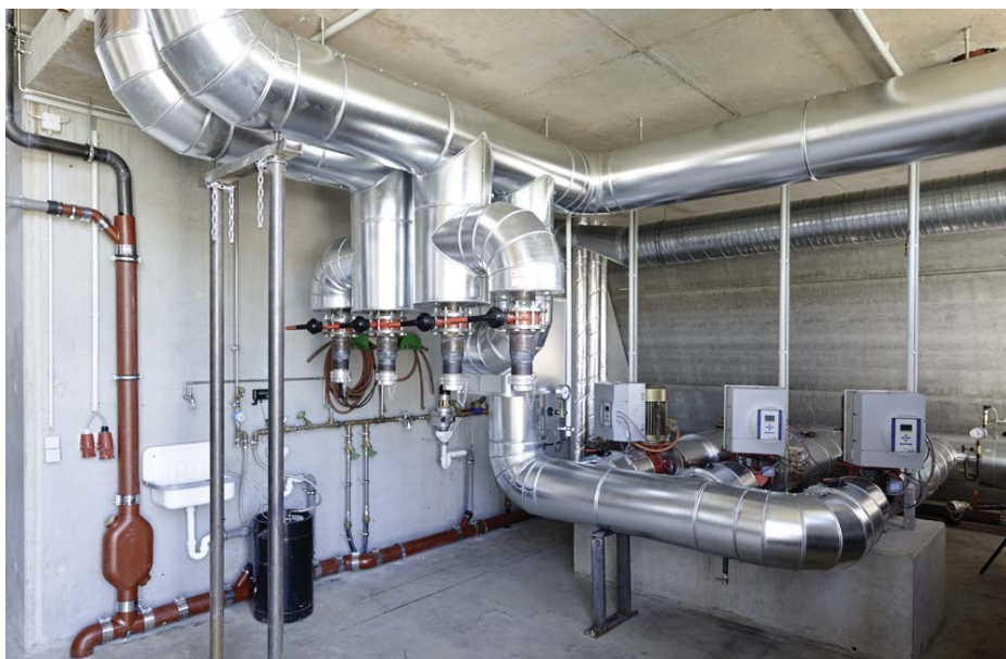
Nahwärmeleitungen mit Netzpumpen in der Heizzentrale in Büsingen
