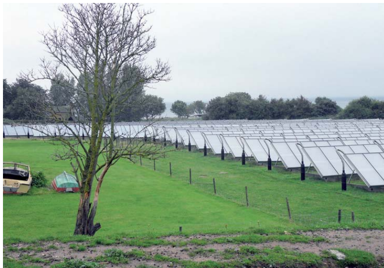
Figura 0-1 Impianto con collettori solari installati a terra (foto: Riccardo Battisti)
