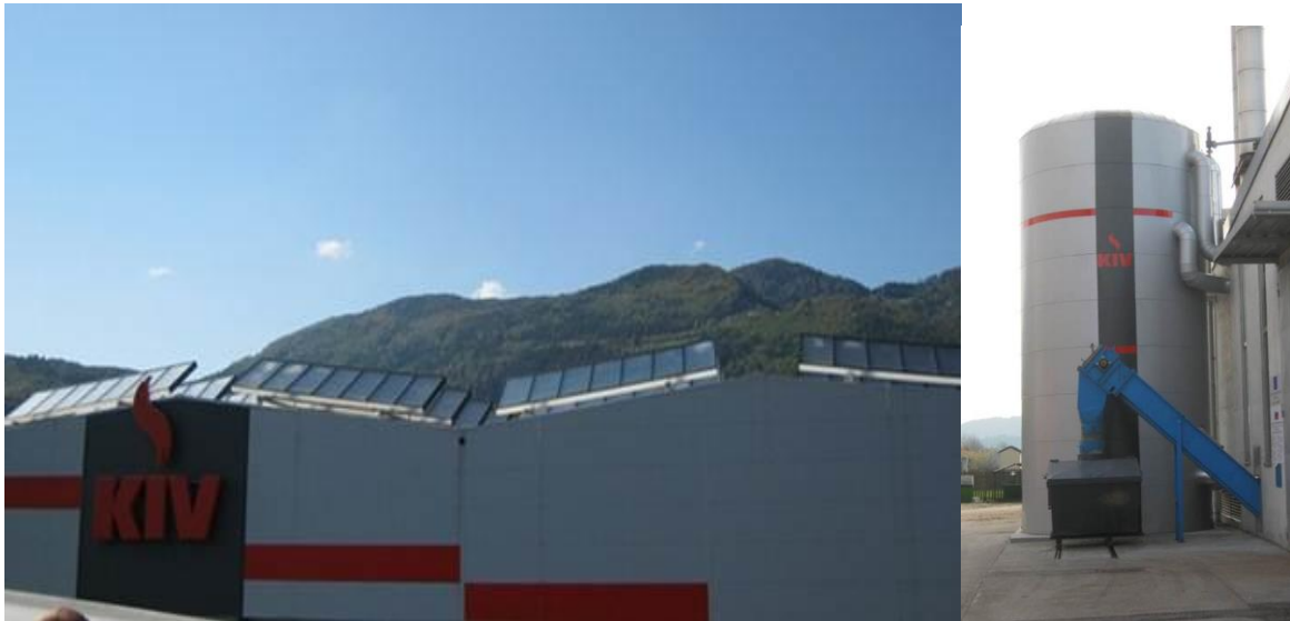
Slika 8: Sprejemniki sončne energije na strehi podjetja KIV. Desno je prikazan hranilnik toplote
