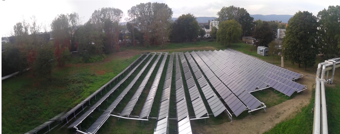
Abb. 4 –Ausschnitt vom Fernheizwerk Graz / Österreich
